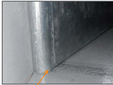
seitliche Räumklappe Achtung: scharfe Kanten! (-> abrunden!)
